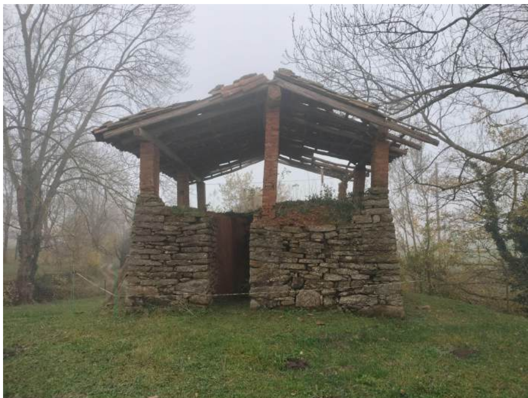
Fotografia on es pot apreciar la inclinació del pilar central
